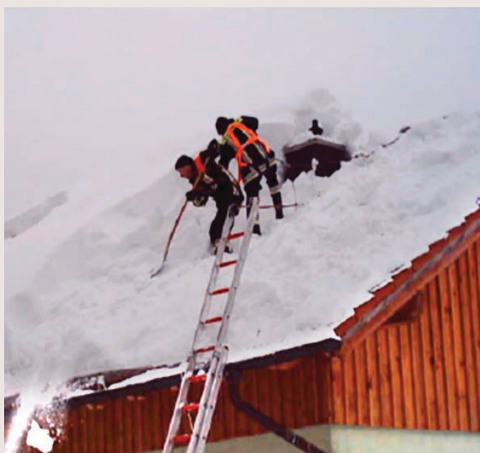
Einsatzkräfte bei der Prävention von Dachlawinen und Einsturzgefährdung.
